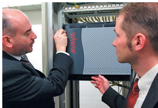
Das «Herz» der ganzen Lösung. Dank IP-Telefonie wurden die technischen Anlagen im Hauptsitz auf ein Minimum reduziert. Avaya S8500/G650
